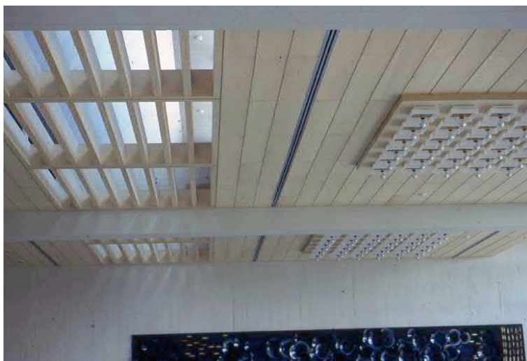
Valtuustosalin katto oli luonnonväristä puuta. Valaisin ja kattoikkuna alkuperäisessä asussa. (Myöhemmin kattoikkuna on täytetty iv-putkilla.) (Kuva Paavo Korhonen)
