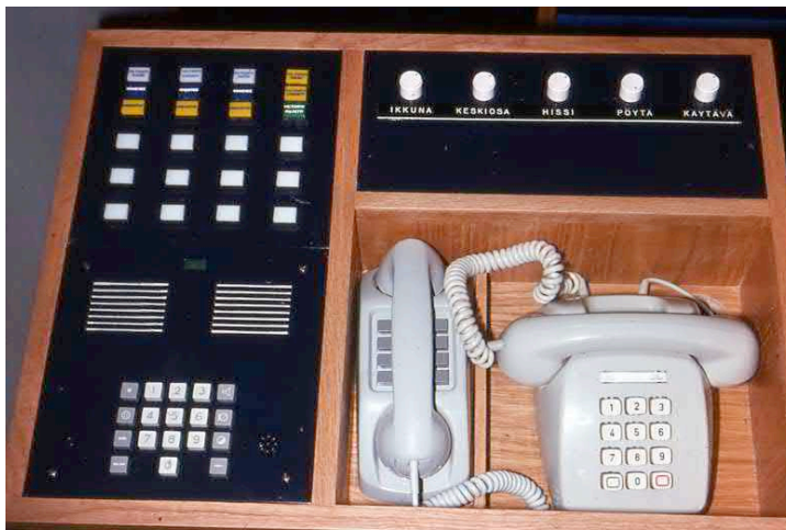
Työpisteen uusi kojepöytä v. 1968 sisälsi hakulaitteen, pikapuhelimen, keskusradion ja nappipuhelimen. (Kuva Paavo Korhonen)
